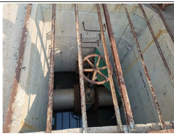
2#初期雨水池雨污切换阀
